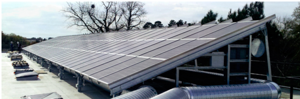
Le solaire photovoltaïque, technique aérovoltaique pour 4 fois plus de rendement
