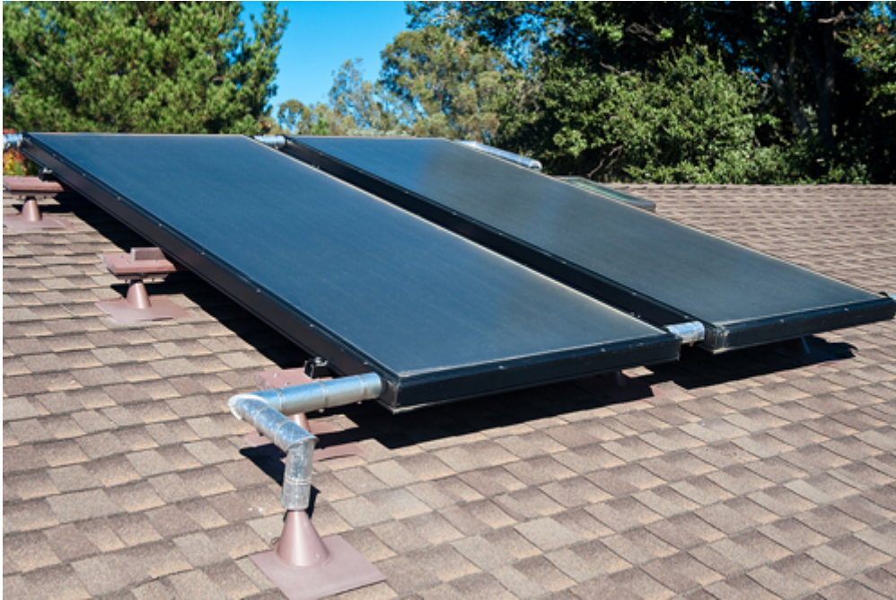
Installation solaire sur le toit d'une maison : pas si compliqué et rentable à long terme
