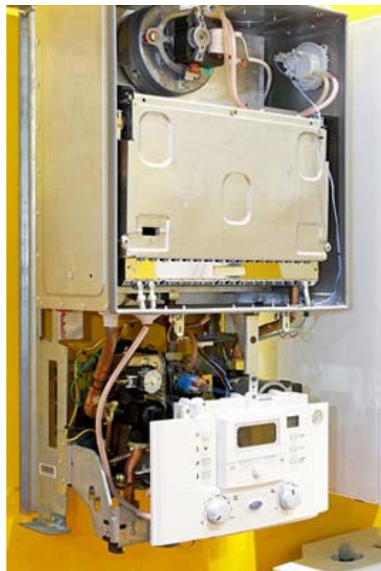
Une chaudière performante n'est pas si simple que cela
