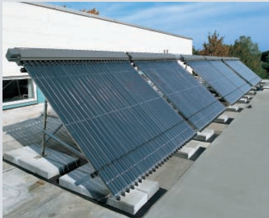
Etablissement scolaire à Siegen-Wenden (Allemagne) équipé de 18 m 2 de capteurs solaires à tubes sous vide Vitosol
